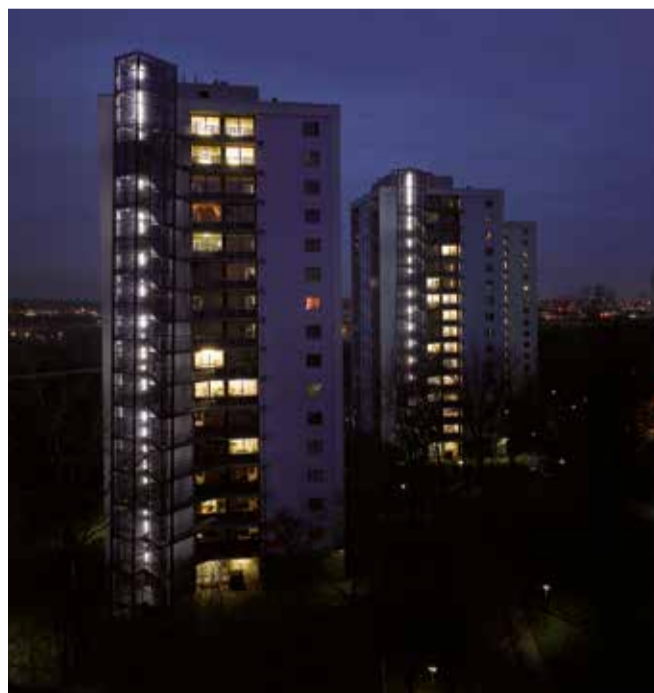
Studentencomplex Rode Kruislaan. Een van de acht studentencomplexen waar een spaartransformator is geplaatst.
